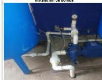
Pruebas de funcionamiento
