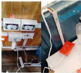
Ilustración 14. Arreglo de cableado
